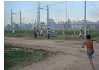
Sub estación de la ANDE
